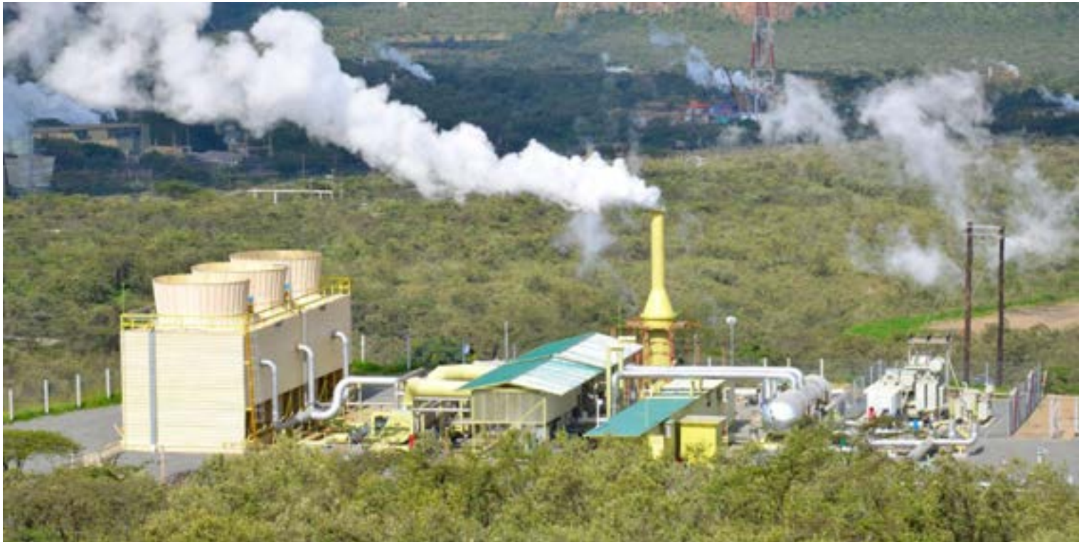
Geotermisk kraftverk i Kenya
