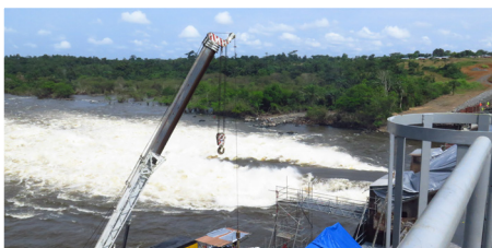
Mount Coffee, vannkraftverk i Liberia, Foto: Jan Speed
