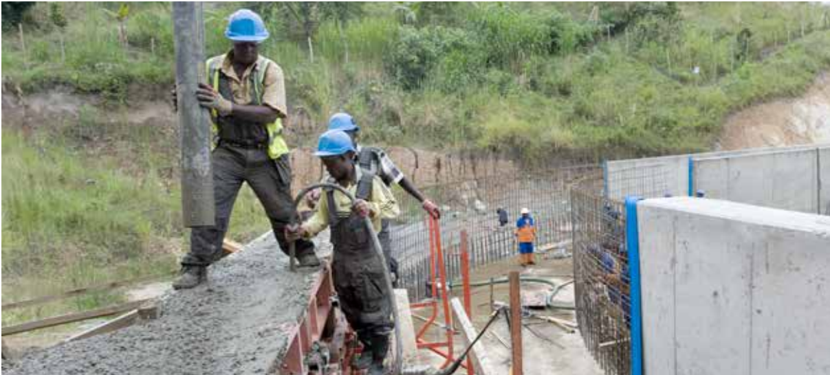
Byggingen av Bugoye skapte mange arbeidsplasser lokalt. Her ved støping av tilløpskanalen. FOTO: KEN OPPRANN
