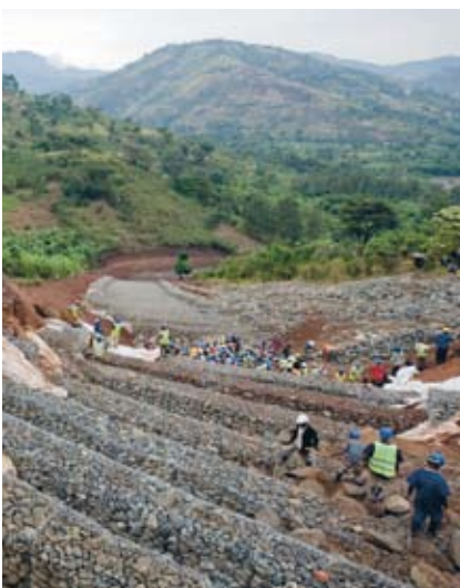
Fra byggingen av kraftverket i Bogoye, som ble åpnet av utviklingsminister Erik Solheim høsten 2009. Trappeavsatser bygges i "overflow weir" ved at stein legges inn i "hønsenetting". Dette avløpet er viktig for å kunne avlede vannmassene når det er ekstra stor vannførsel i kanalen.
