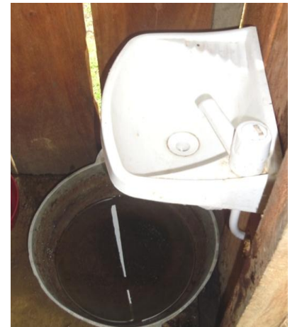
Ilustración 6: Lavamanos cerca de taza sanitaria.
