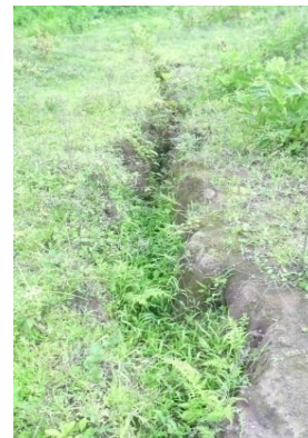
Ilustración 7: Tramo de línea de conducción erosionado.
