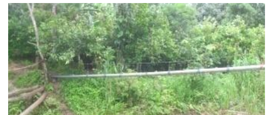
Ilustración 14: Cruce de tubería aérea expuesta.
