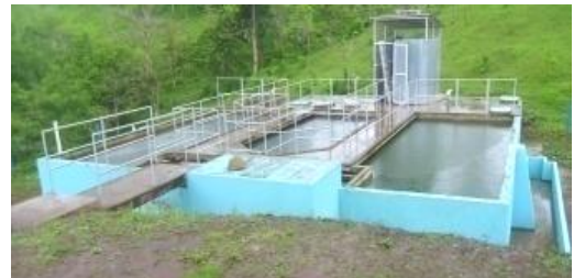
Ilustración 12: Filtración lenta y al final tanque de almacenamiento.
