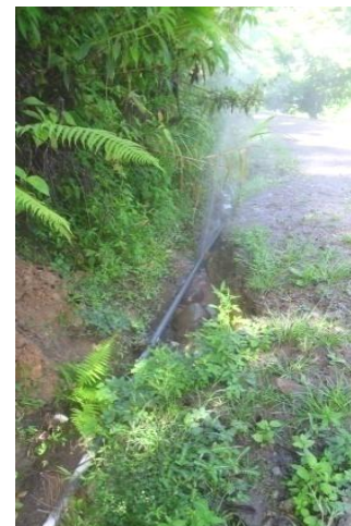
Ilustración 17: Tubería erosionada y con ruptura en la carretera a El Naranjo.
