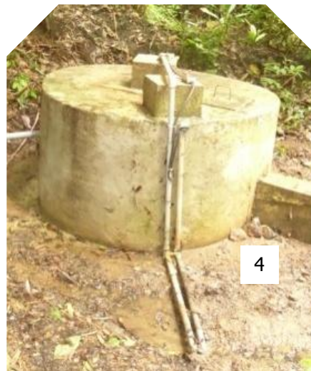
Ilustración 25: Cárcamo de bombeo con bomba sumergible.
