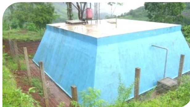
Ilustración 18: Tanque trapezoidal de mampostería, se observa el sistema de cloración de carga constante.
