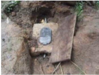
Ilustración 11: Caja de protección de medidor.
