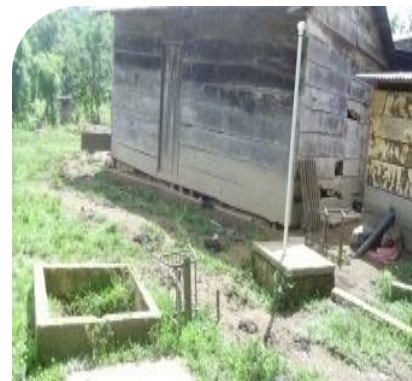
Ilustración 28: Conexión sanitaria con tubería saliendo de la caseta (derecha).
