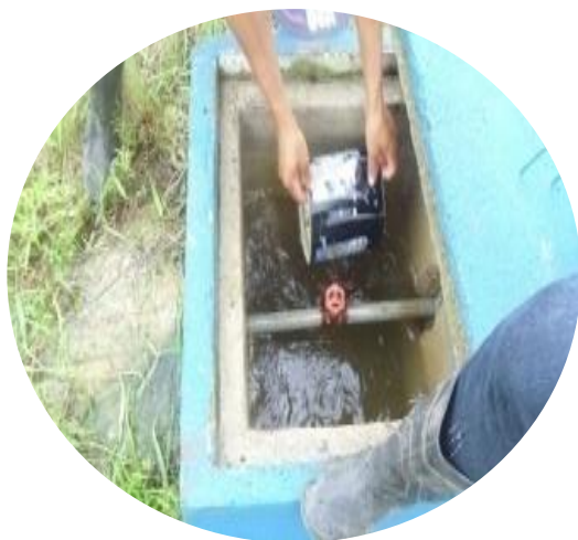
Ilustración 26: Llave de pase del tanque con problemas de filtración.
