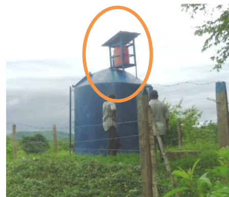
Ilustración 22: Clorador mal ubicado sobre el tanque.
