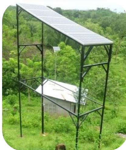
Ilustración 24: Paneles solares para bombeo eléctrico.
