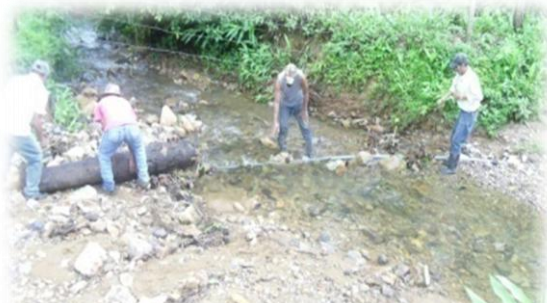
Ilustración 16: Línea de conducción expuesta en una quebrada.
