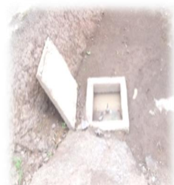
Ilustración 27: Caja con válvula aun no recepcionada, obsérvese al lado corte de suelo sin revestimiento.
