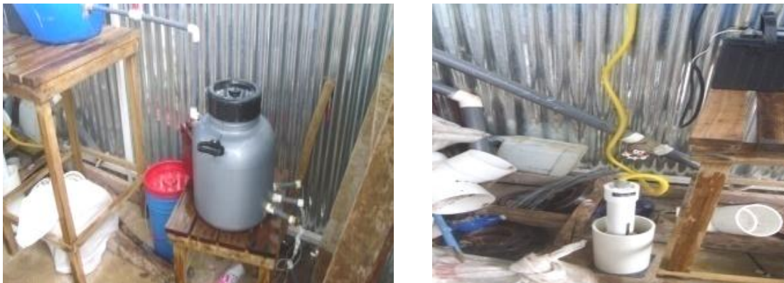
Ilustración 15: Caseta de cloración, obsérvese el desorden.
