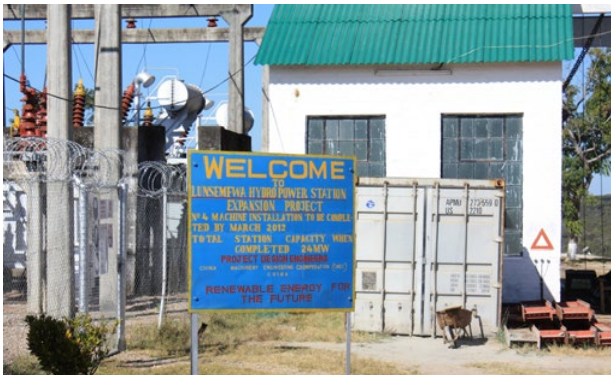
Velkommen til kraftstasjonen Lunsemfwa som eies 51 prosent av norske Agua Imara/ SN Power. FOTO: ARVE OFSTAD
