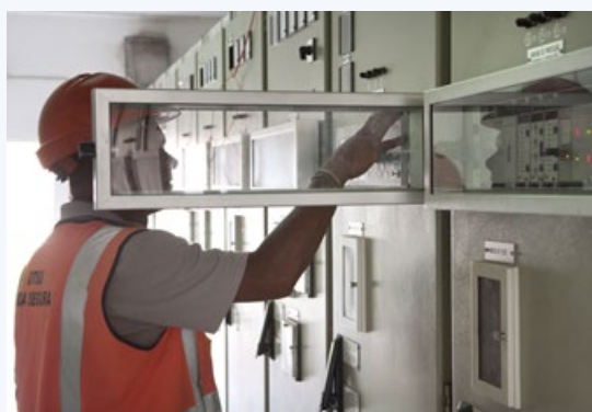
Koblingsstasjonen CTM forsyner Mosambiks to største byer med kraft. Bildene viser deler av den gamle stasjonen som nå er under oppgradering. FOTO: KEN OPPRANN
